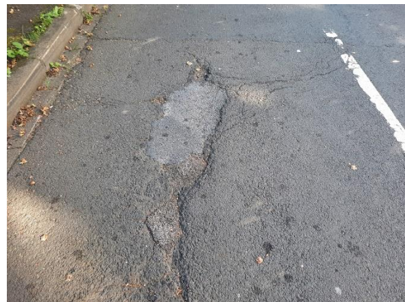
Abbildung 216: Straßenschäden in der Gelbachstraße / K 161 im Bereich der Spannhecker Straße
