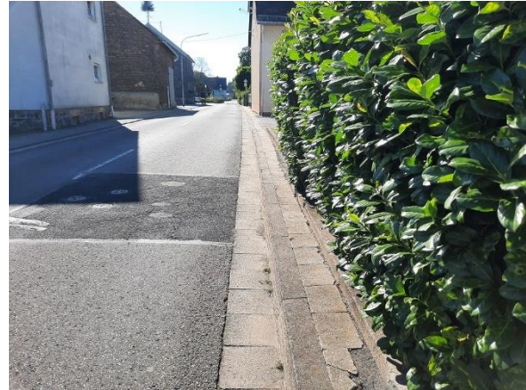
Abbildung 215: Deutlich zu schmaler Bürgersteig an der Schulstraße / K 165
