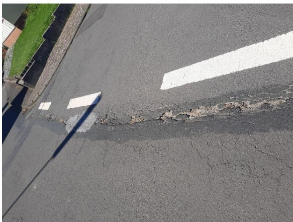
Abbildung 217: Straßenschäden in der Gelbachstraße / K 161 im Bereich der Eichheider Straße
