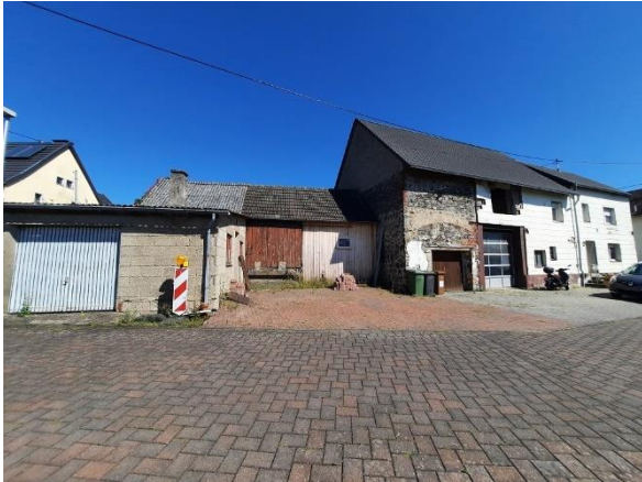
Abbildung 90: Gebäudekomplex aus Wohnhaus und mehreren Nebengebäuden mit Sanierungsbedarf in der Rothbornstraße
