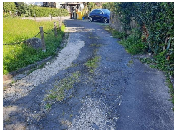
Abbildung 218: Straßenschäden im Abzweig der Sespenroder Straße am Schleimersplatz
