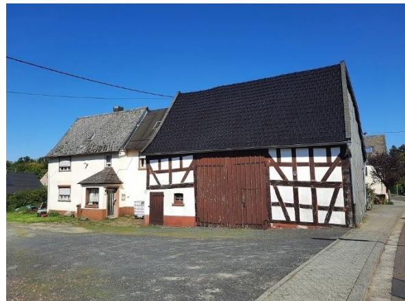
Abbildung 93: Nebengebäude mit Sanierungsbedarf in der Schulstraße
