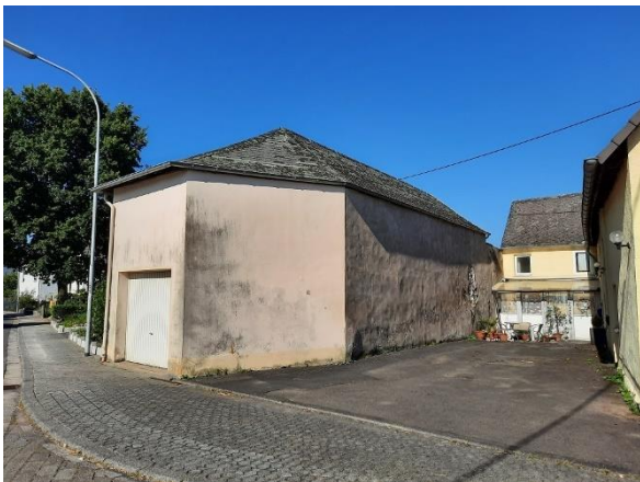
Abbildung 92: Nebengebäude mit Sanierungsbedarf in der Isselbacher Straße
