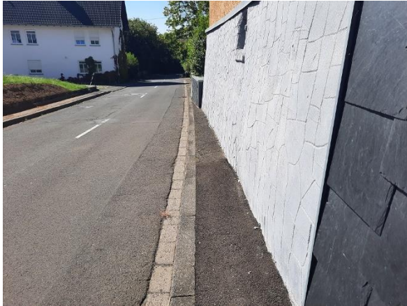
Abbildung 214: Deutlich zu schmaler Bürgersteig an der Gelbachstraße / K 161
